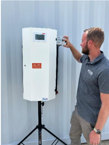
Diese Abbildung zeigt die Standard-Übergabestation bis 50 kW. Abweichungen sind möglich.
