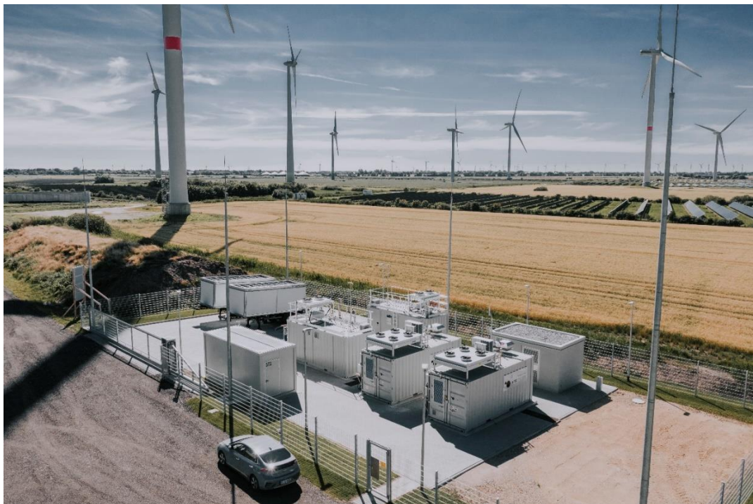
Wasserstoffproduktionsanlage in Bosbüll: Hier entsteht der Wasserstoff für das efarm-Projekt in Nordfriesland.
