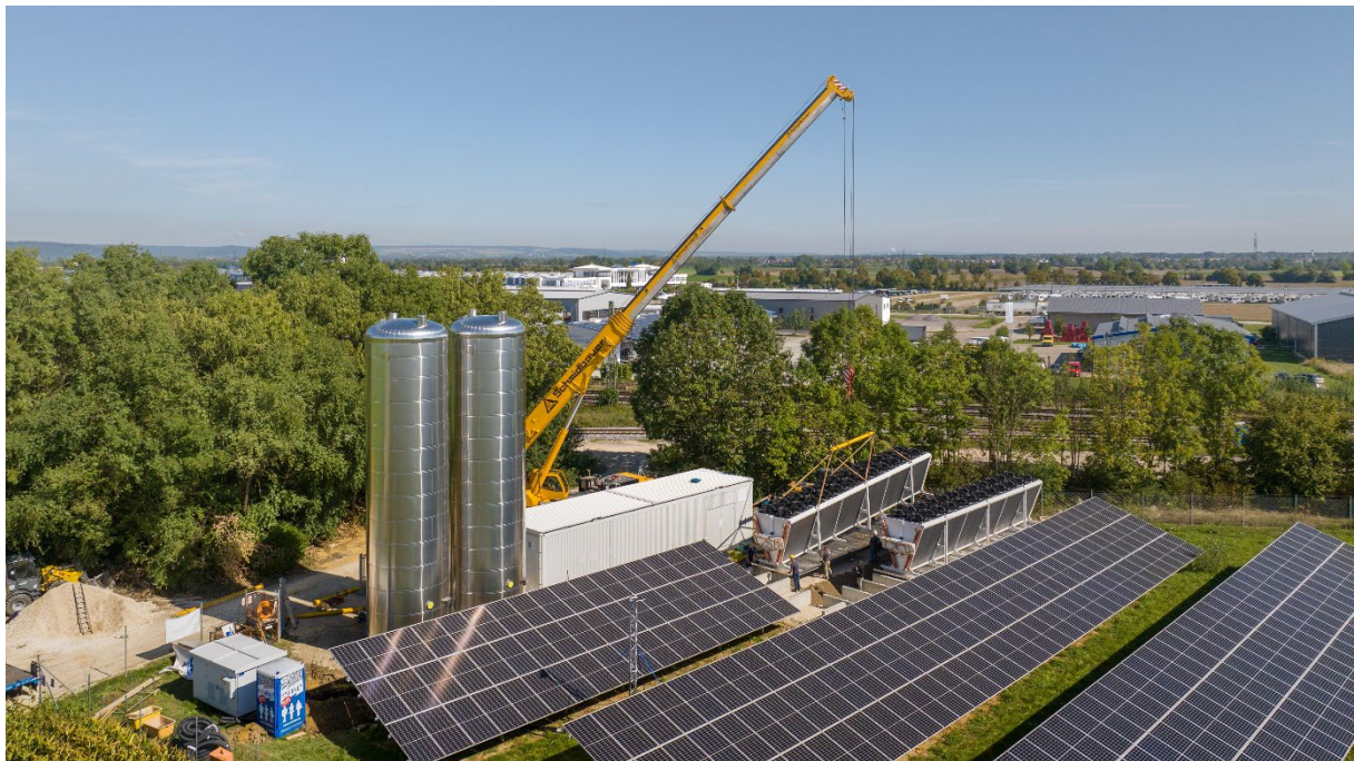
BU 1: Die Photovoltaik-Anlage samt Heizzentrale in Mertingen.
