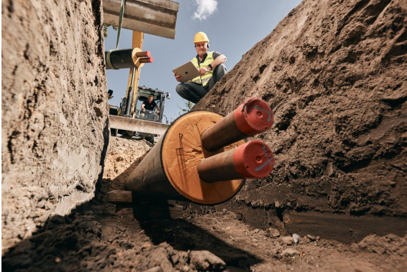
BU 1: Ein Wärmerohr wird verlegt. Hier fließt schon bald günstige, nachhaltige Wärme.
