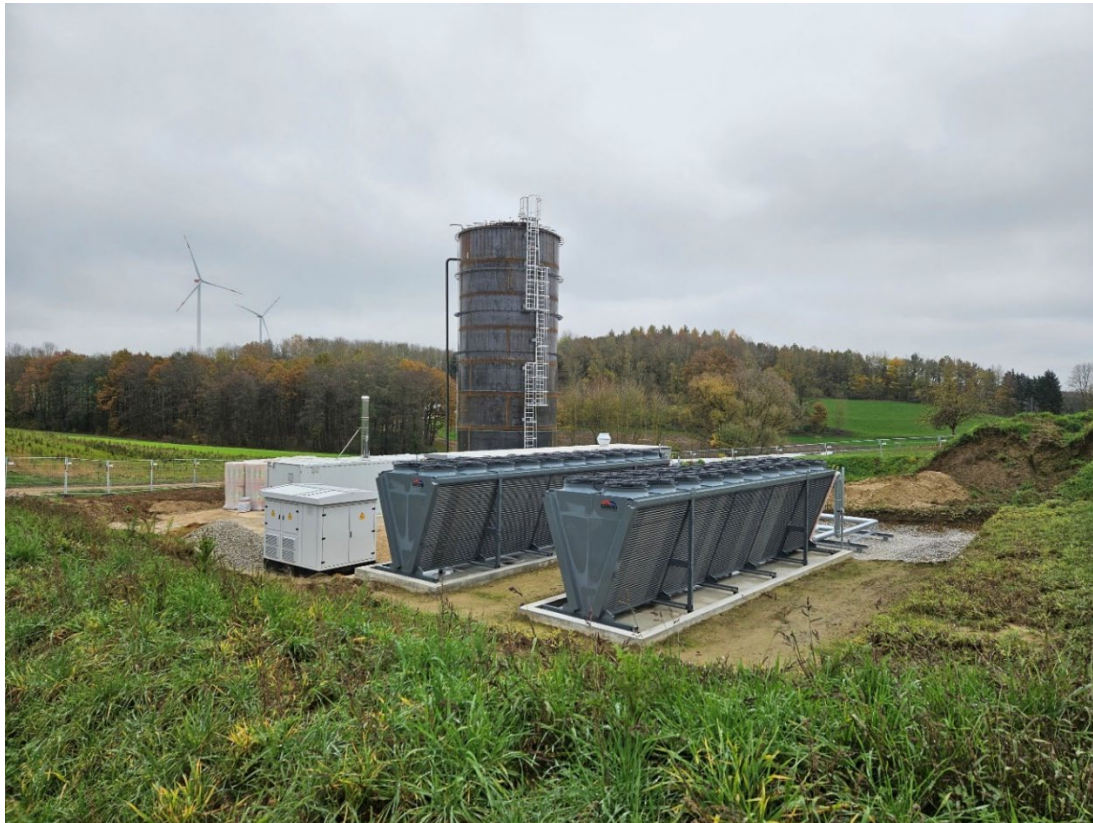
BU 1: In Buttenwiesen wurde eine neue Heizzentrale gebaut. Wärmepumpe, Pufferspeicher und Rückkühler arbeiten bereits. Was noch fehlt, ist sind die Außenanlagen.
