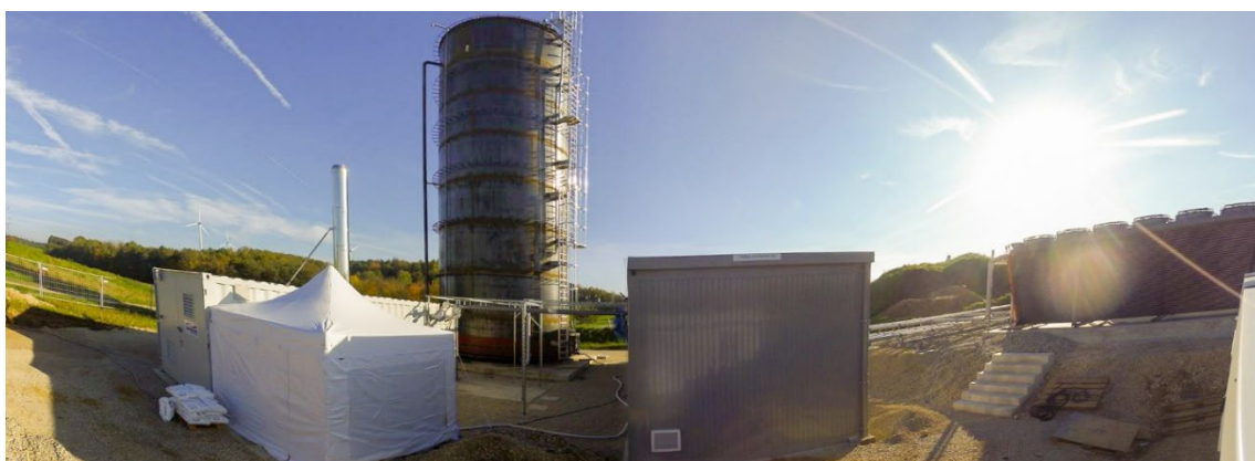
BU 2: Die Großwärmepumpe hat mehr als 1 Megawatt Leistung und ergänzt die anderen Erzeugungsanlagen des Wärmenetzes.
