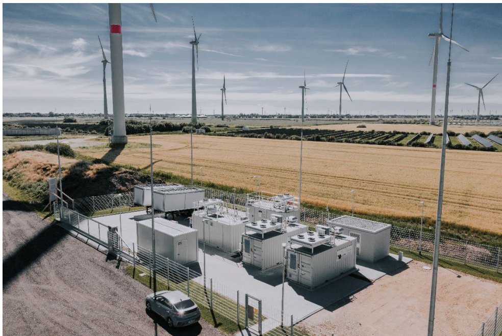
BU 2: Wasserstoffproduktionsanlage im ebenfalls von GP JOULE initiierten und betriebenen Projekt eFarm. Foto: GP JOULE
