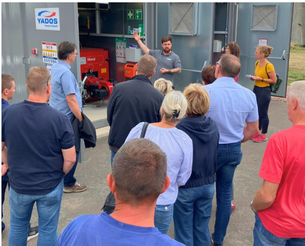
BU: Im Rahmen der feierlichen Inbetriebnahme bekamen interessierte Bürgerinnen und Bürger direkte Einblicke in die neue Heizzentrale.
