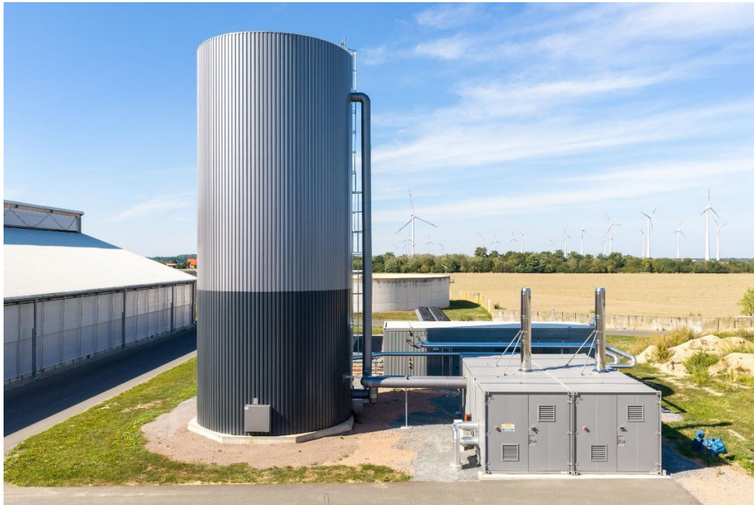
BU: Die Großwärmepumpe und der rund 17 Meter hohe Pufferspeicher übernehmen schon seit Juni die verlässliche und saubere Wärmeversorgung der Gemeinde.
